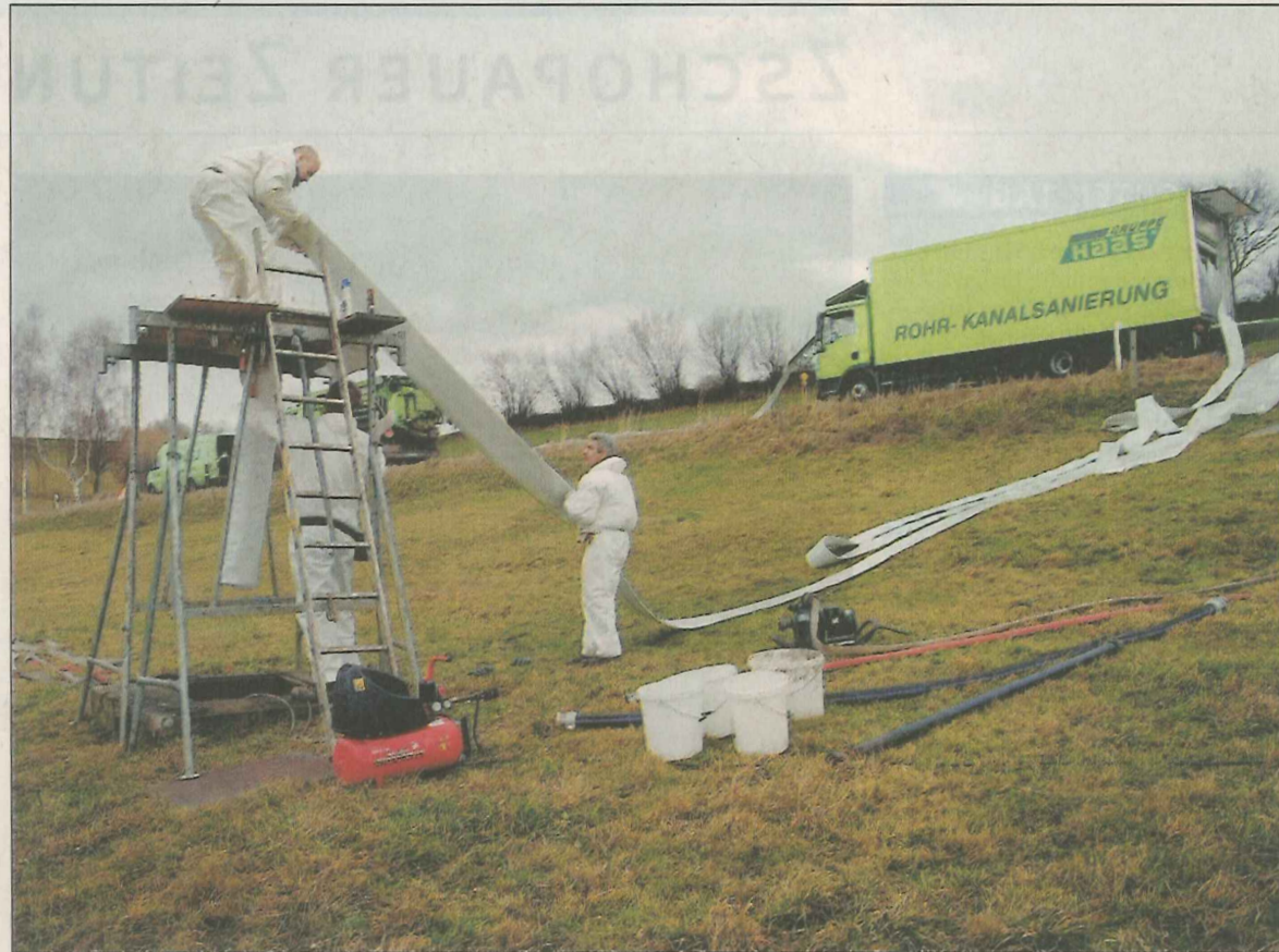
Mitarbeiter der Chemnitzer Niederlassung der Firma Haas sanieren mit einer „Verbund-Inliner-Technik“ den maroden Sammler. Nach dem Befüllen des Mantels wird das noch weiche Rohr in den Schacht eingeführt. Von links: Michael Krüger, Marco Krieger und Wolfgang Hadrion.
