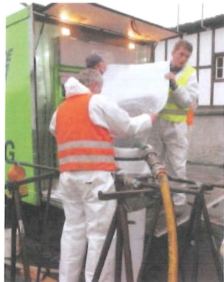
Führen die Sanierung von Rohrabschnitten mittels Inliner-Verfahren durch: Die Arbeiter in der Schottener Kernstadt. Bild: Weil
